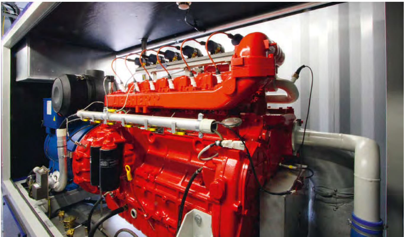
Bild 12.9: Insgesamt 52 Blockheizkraftwerke wie dieses auf der Kläranlage Sundern helfen dem Ruhrverband dabei, seinen Energiebezug zu senken Fig. 12.9: A total of 52 small power units like this one at the wastewater treatment plant in Sundern reduce the Ruhrverband's demand for external energy supply
