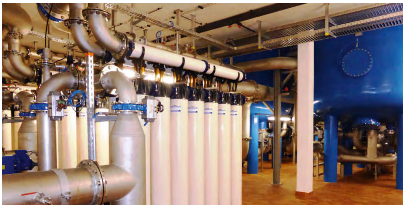
Bild 16.2: Ultrafiltrationsmembranmodule im WW Hennese Fig. 16.2: Ultrafiltration membrane module at the waterworks Lake Henne
