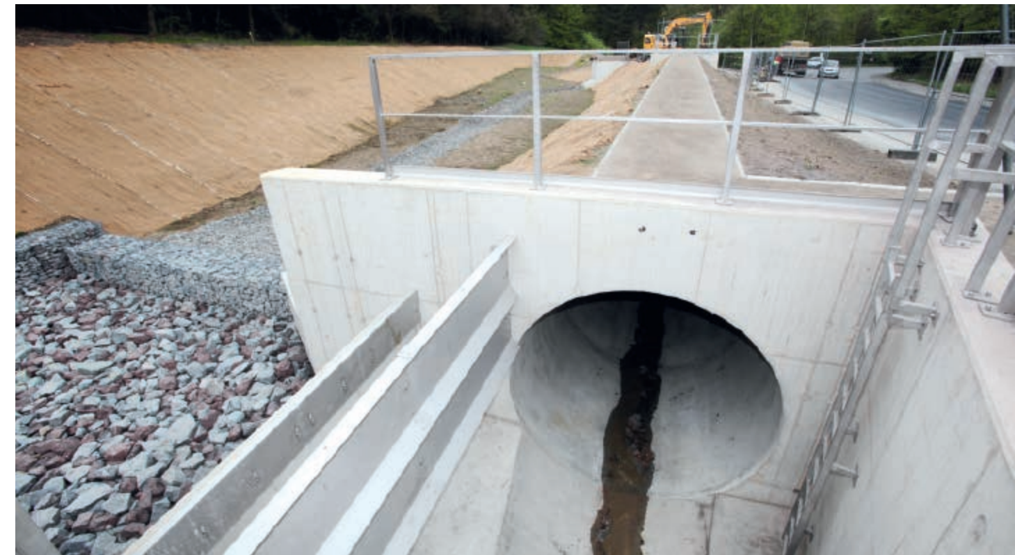
Der Regenüberlauf Scharpenberger Straße in Ennepetal wurde durch einen Stauraumkanal und ein Regenrückhaltebecken ersetzt.
