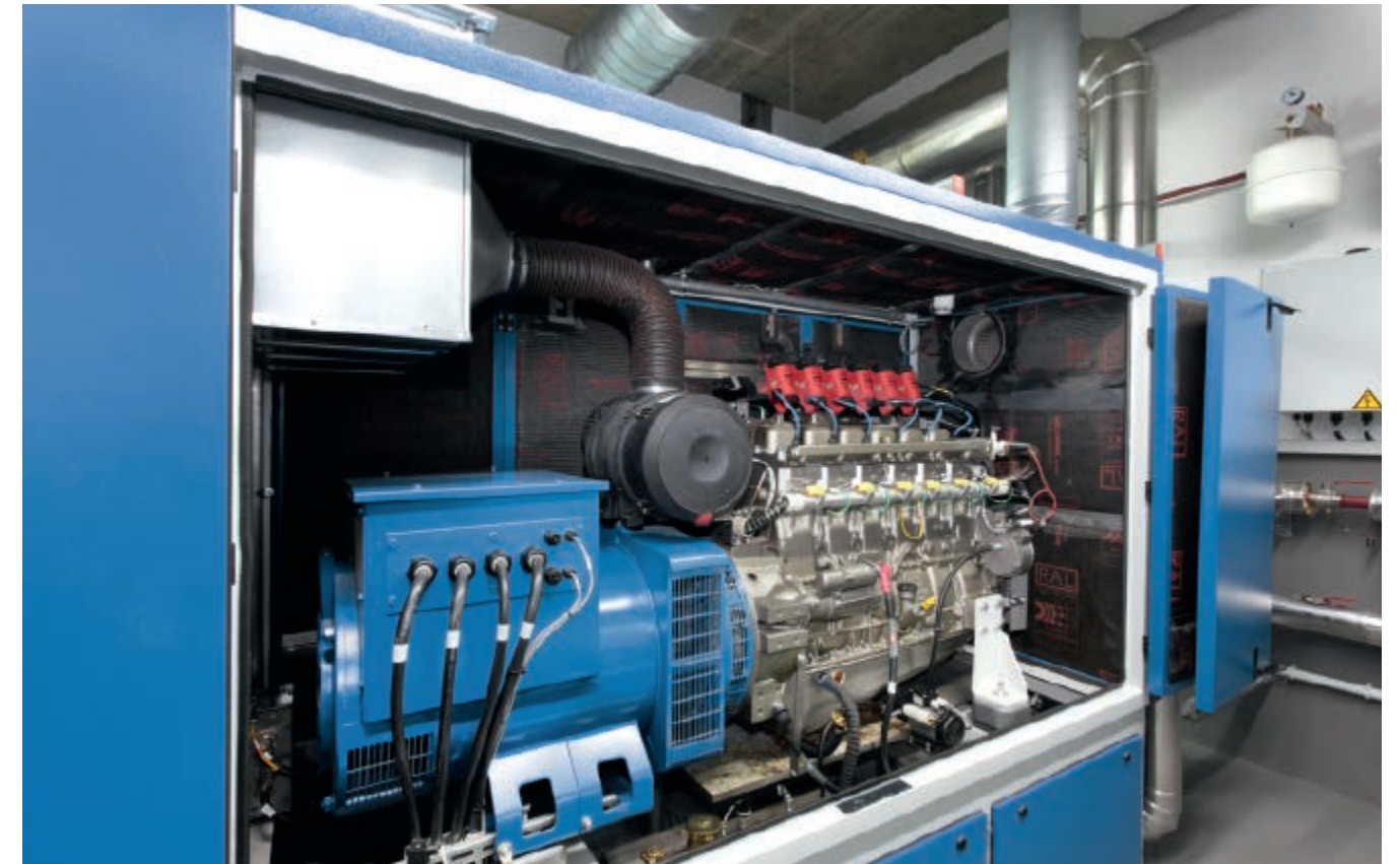
Auf der Kläranlage Lüdenscheid-Schlittenbachtal wurde ein weiteres Blockheizkraftwerk in Betrieb genommen.
