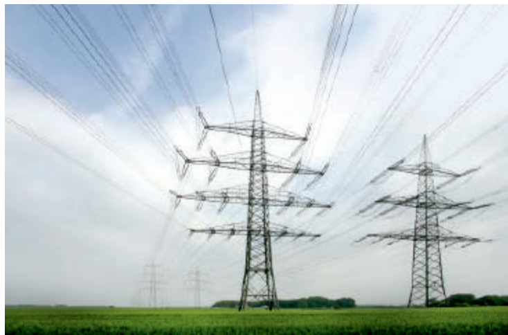
Das wesentliche Ziel der Energiepolitik des Ruhrverbands ist die sichere und wirtschaftliche Versorgung der Abwasseranlagen mit Energie.
