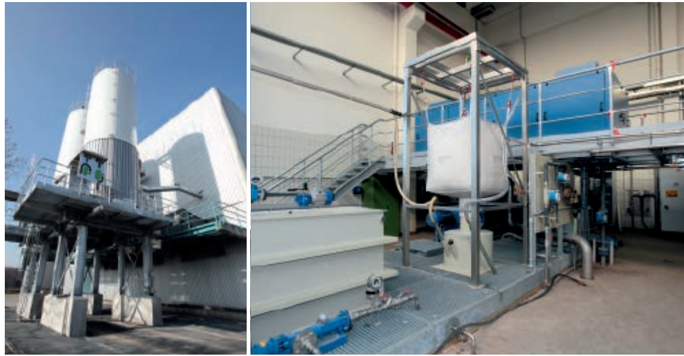
Kläranlage Duisburg-Kaßlerfeld: Der in den Zentrifugen (rechts) entwässerte Schlamm wird in den neu errichteten Schlammsilos (links) gespeichert.
