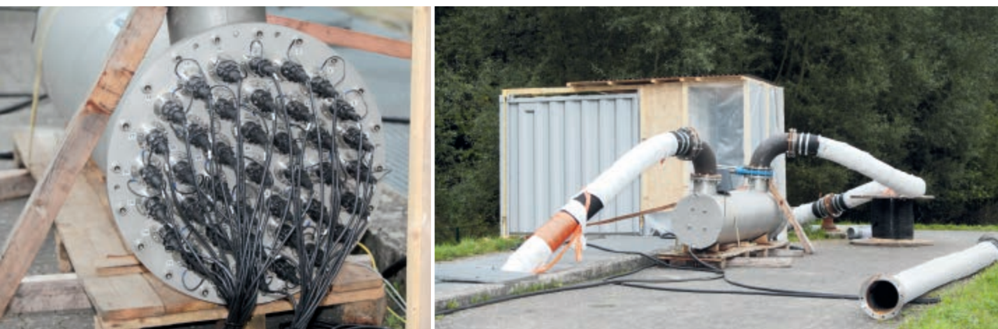
Die Installation einer UV-Desinfektionsanlage gehörte zu dem Maßnahmenprogramm, das der Ruhrverband unmittelbar nach Bekanntwerden der Legionellenproblematik ergriffen hat.
