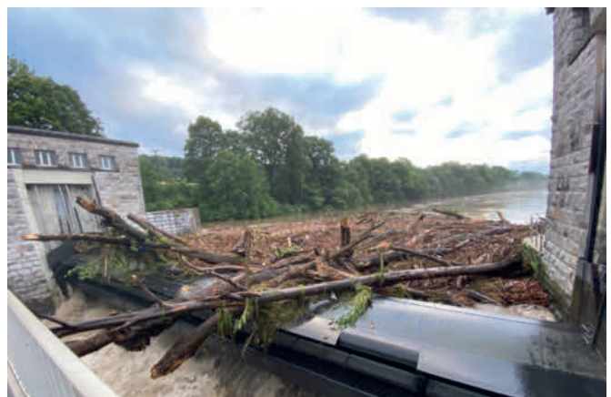
Bild 17.1: Ansammlung von Treibgut an der Wehrklappe des Wasserkraftwerks Echthausen (WWW) Fig. 17.1: Flotsam accumulating at the weir gate of the hydropower station Echthausen (WWW)
