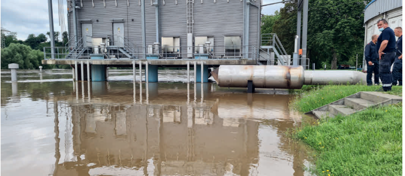
Bild 17.6: Abgasrohre der Notstromdieselanlage des Pumpwerks Essen-Horst mit THW-Mitarbeitern während des Hochwasserscheitels (WGE) Fig. 17.6: Exhaust pipe of the diesel-powered emergency electricity supply system at the pumping station Essen-Horst with employees of Germany's Federal Agency for Technical Relief (THW) during the flood peak (WGE)
