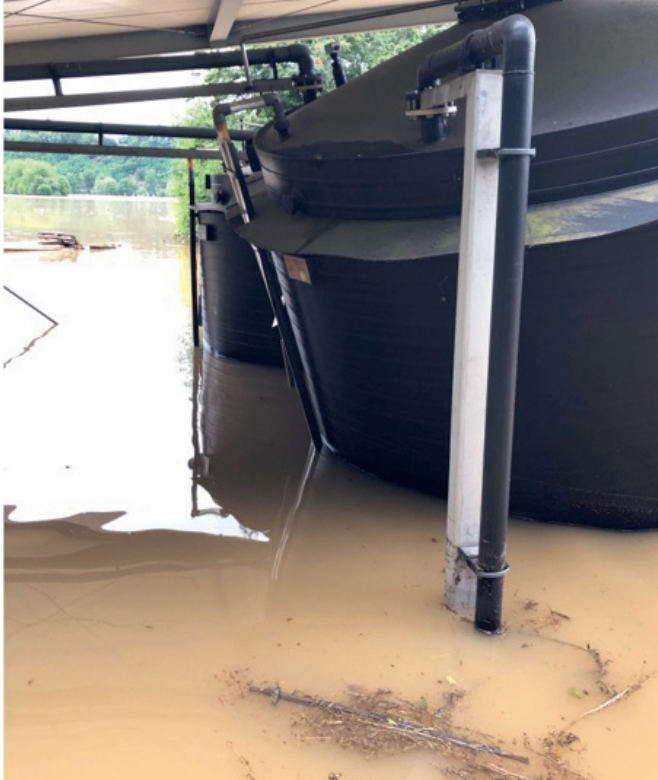
Bild 17.4: Aufgetriebene Flockungsmittelbehälter am Sedimentationsbecken des Wasserwerks Witten (WWW) Fig. 17.4: Uplifted flocculants at the sedimentation tank of the waterworks Witten (WWW)
