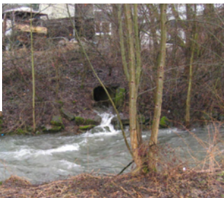
Einleitungsstelle von Niederschlagswasser
