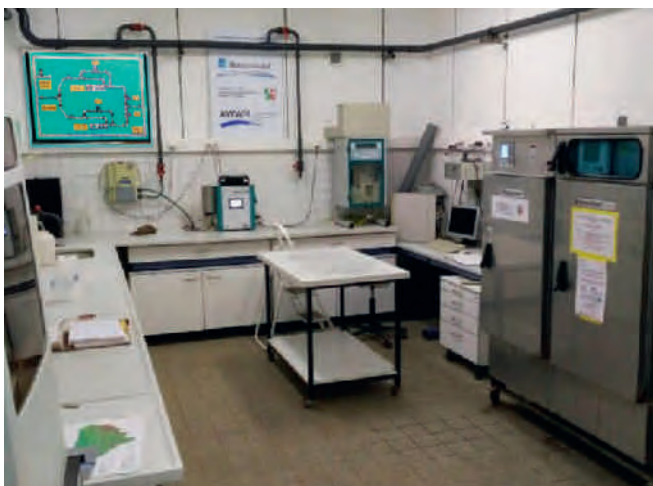
Bild 3.3: Gewässerüberwachungsstation Hattingen Fig. 3.3: Water quality monitoring station Hattingen
