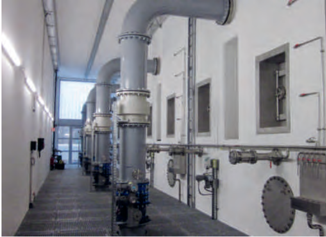
Bild 16.9: Fünf geschlossene Aktivkohlebehälter Fig. 16.9: Five closed containers with activated carbon
