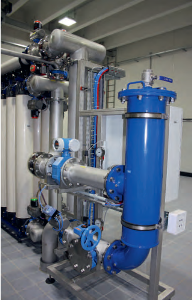
Bild 16.2: Zulauf-Verrohrung mit Messtechnik und Armaturen vor einem Modulblock
