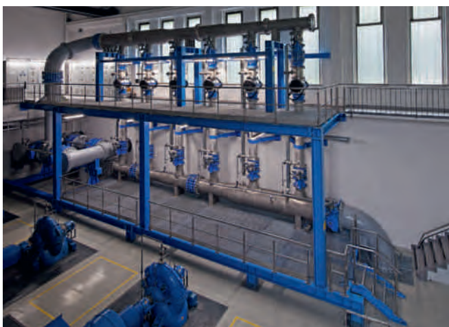
Bild 16.8: UV-Anlage Fig. 16.8: UV facility
