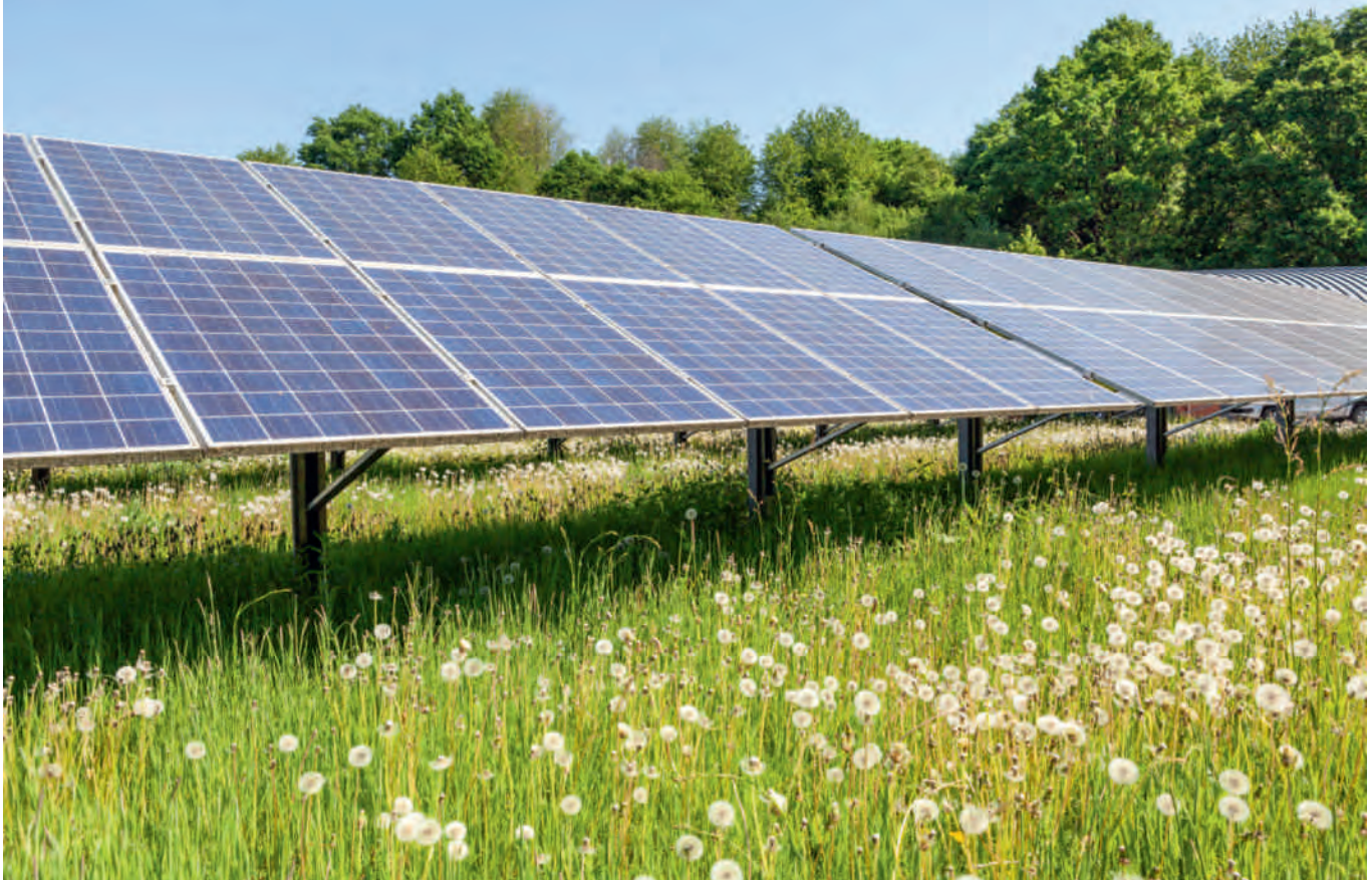
Bild 12.8: Zwölf Photovoltaikanlagen wie diese auf der Kläranlage Essen-Kettwig helfen dem Ruhrverband dabei, seinen Energiebezug zu senken. Fig. 12.8: Twelve photovoltaic systems like this one at the wastewater treatment plant in Essen-Kettwig reduce the Ruhrverband's demand for external energy supply.
