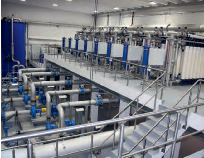
Bild 16.4: Gesamt-Anlage mit 8 Modulblöcken inkl. Schaltschränken, Zulauf- und Rückspülpumpen, Abwassertanks und Verrohrung Fig. 16.4: Complete facility with 8 module blocks including switch-boards, inflow and backwash pumps, wastewater tanks and pipework
