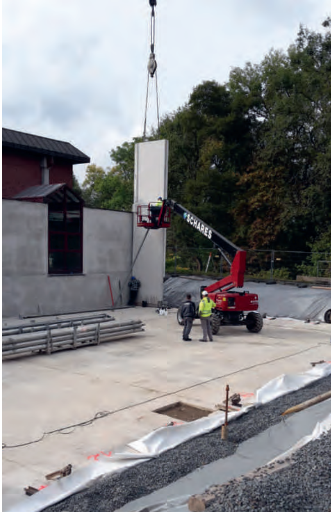
Bild 16.3: Aufstellen der Fertigbetonwände auf die Decke der Reinwasserkammer (08.10.2016) Fig. 16.3: Setting up prefabricated concrete walls on top of the pure water
