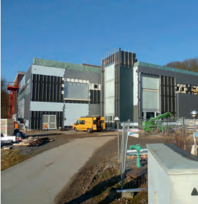
Bild 16.13: Weitergehendes Aufbereitungsgebäude für Adsorptionsbecken und physikalische Entsäuerungsanlage Fig. 16.13: Advanced treatment building for adsorption tanks and physical deacidification
