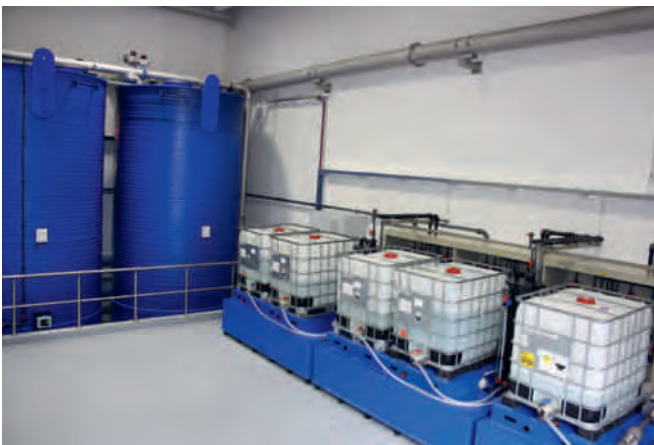
Bild 16.5: Chemikalien-Station für CEB (Chemically enhanced backwash, chemikalienunterstützte Rückspülung), im Hintergrund Abwassertanks, einer zur Neutralisation Fig. 16.5: Chemicals station for CEB (chemically enhanced backwash), wastewater tanks in the background, one for the purpose of neutralization
