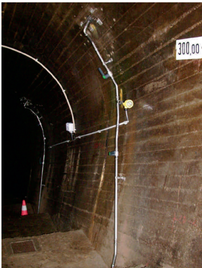
Bild 18: Installation zur Erfassung der Stauhöhe an der Hennetalsperre im Kontrollstollen
