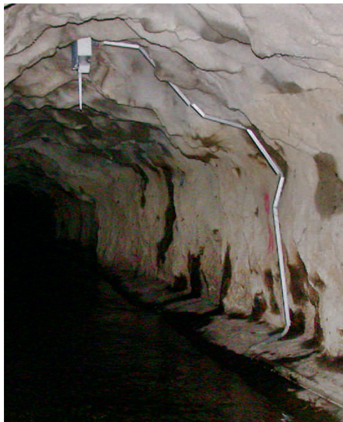
Bild 21: Installierter Radarsensor im Brabecke-Beileitungsstollen Fig. 21: Radar sensor installed in the Brabecke water diversion gallery
