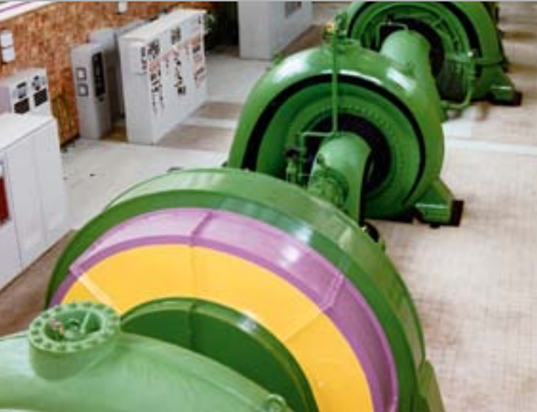
Talsperrenwasser treibt auch Kraftwerksturbinen an, wie hier an der Sorpetalsperre.
