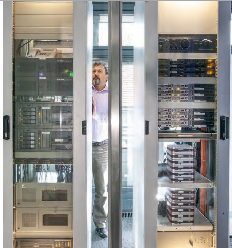
Zentralrechner in der Talsperrenleitzentrale des Ruhrverbands in Essen.
