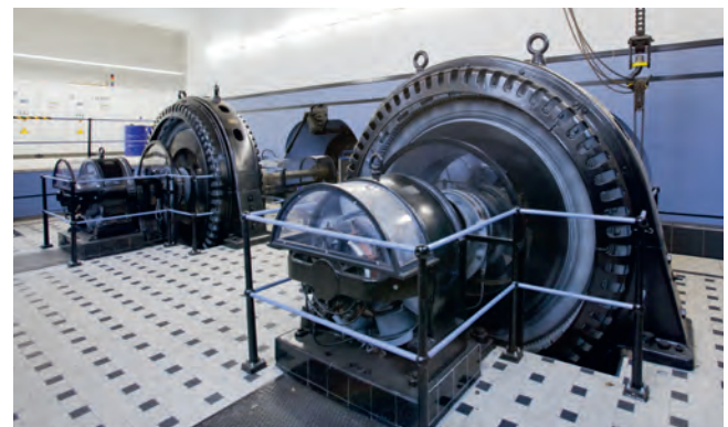
Elf Wasserkraftwerke gehören zum Kraftwerkspark der LLK.
