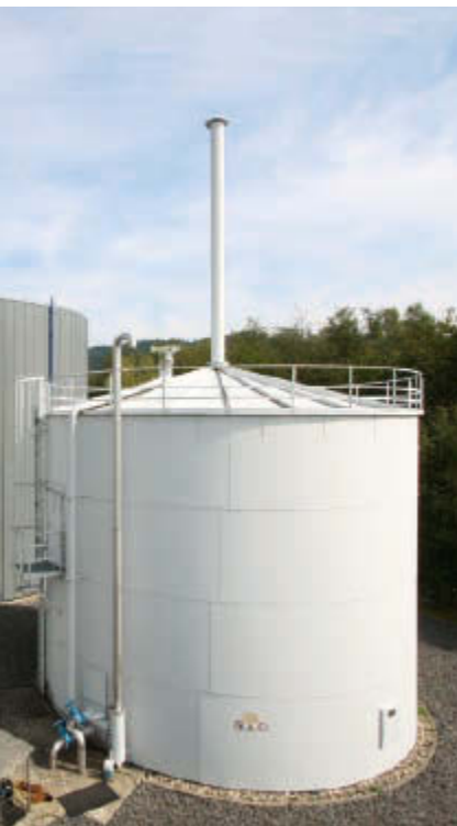
Auf der Kläranlage Arnsberg-Wildshausen hilft ein zweiter Gasspeicher dabei, den Stromeigenversorgungsgrad weiter zu steigern.
