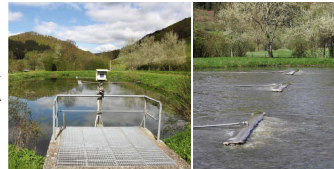
Die belüfteten Abwasserteiche der Kläranlage Schmallenberg-Westfeld sind dazu ausgelegt, das Abwasser von 1.700 Einwohnergleichwerten biologisch zu reinigen.
