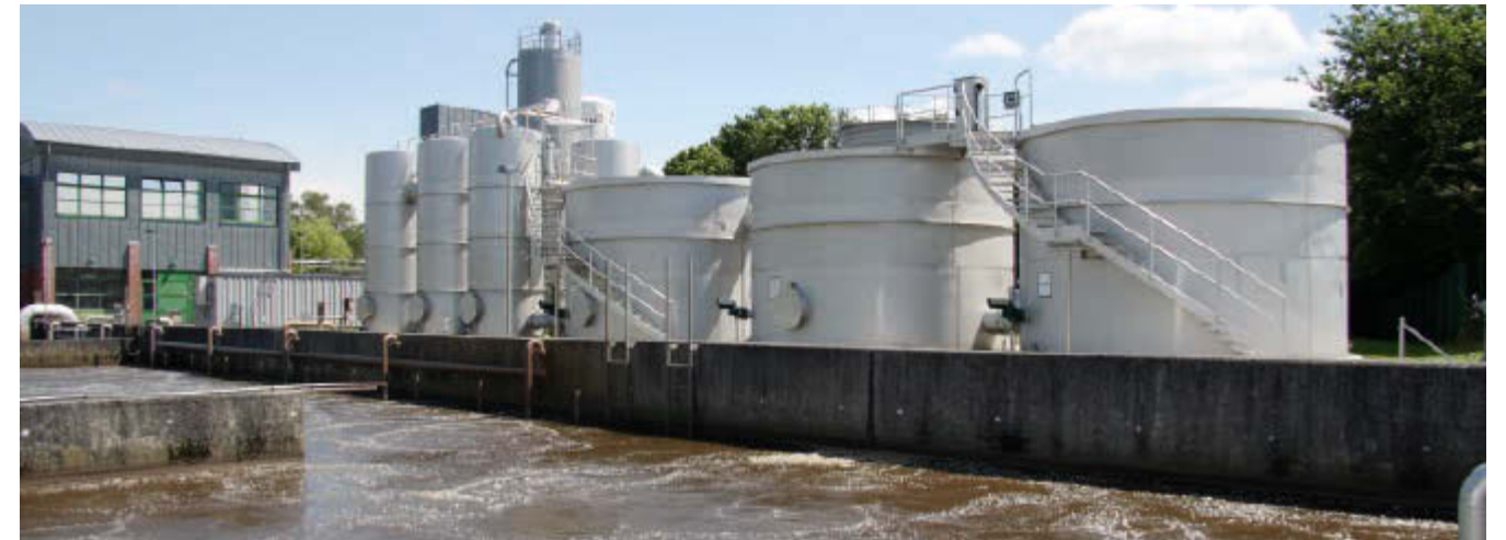
Die großtechnische Versuchsanlage auf der Kläranlage Schwerte.
