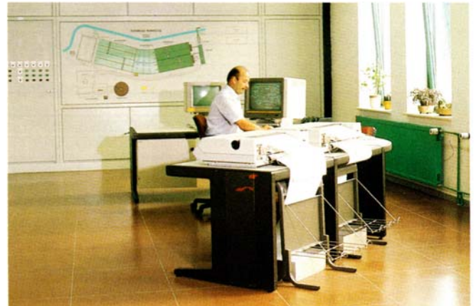
Betriebswarte mit EDV-Anlage
