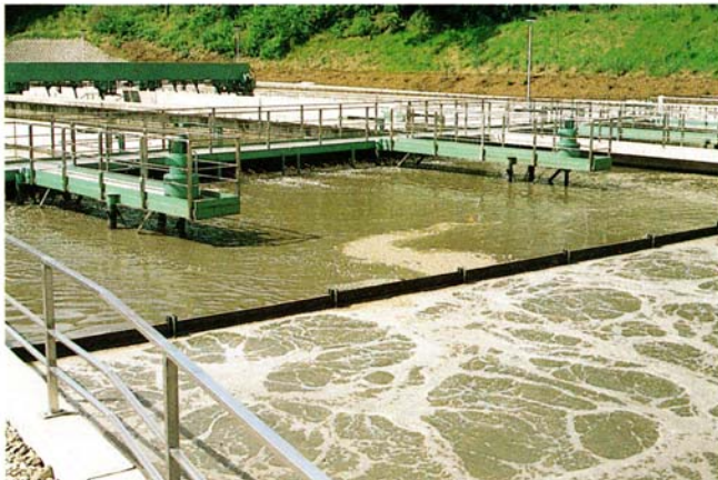
Belebung mit Denitrifikations- (oben) und Belüftungszone
