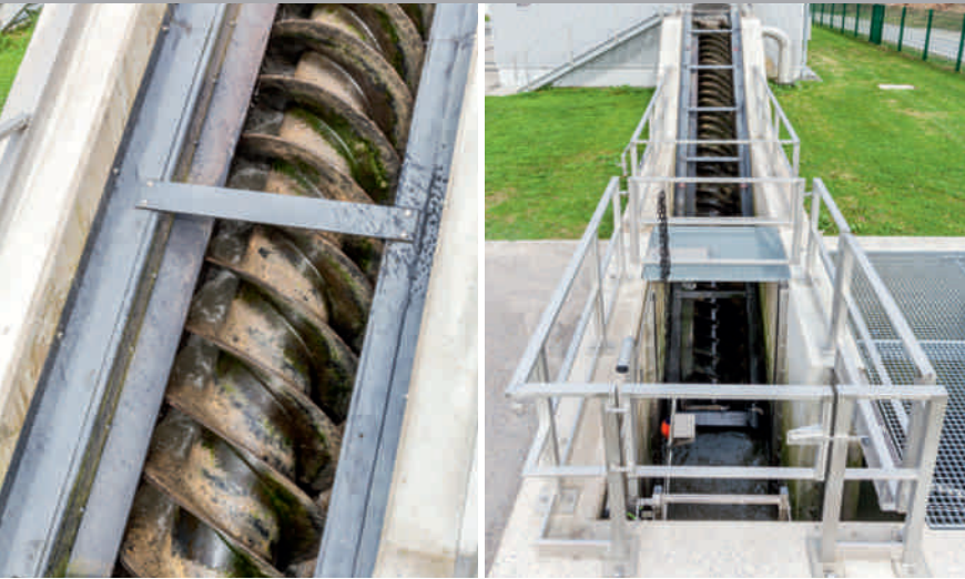
Zulaufhebewerk mit Schneckenpumpe
