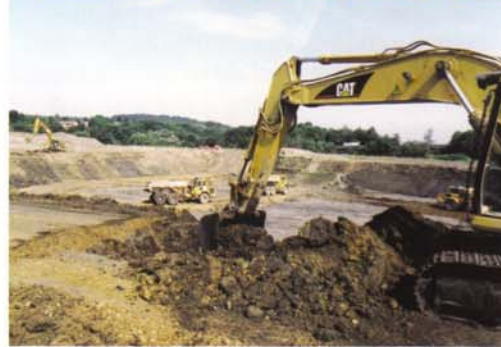
Vorarbeiten zum Bau der Kläranlage Essen-Süd: Sedimentumlagerung auf den Spülfeldern an der Wuppertaler Straße
