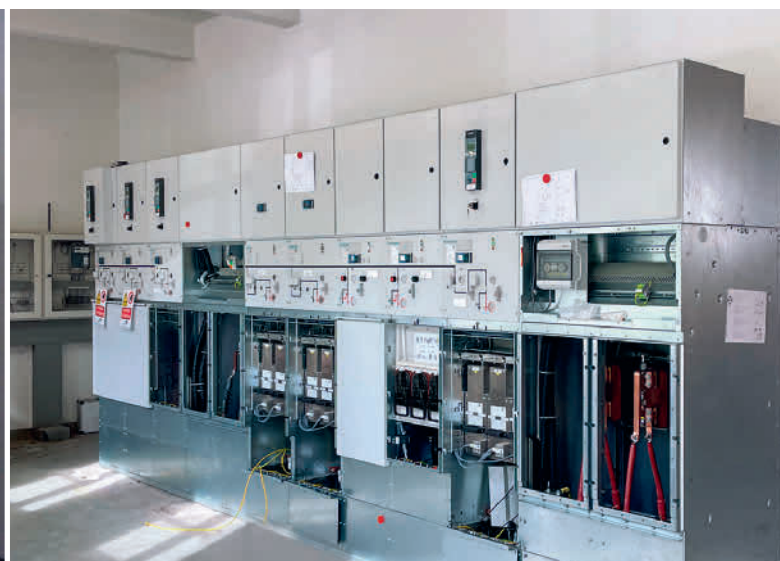
Links: Die alte Mittelspannungsschaltanlage des Kraftwerks der Sorpetalsperre hat ausgedient. Rechts: Mit der neuen Mittelspannungsschaltanlage ist das Wasserkraftwerk nun „schwarzstartfähig“ und es kann bei einem Blackout im Inselbetrieb zur Aufrechterhaltung der Sunderaner Trinkwasserversorgung Strom produzieren.
