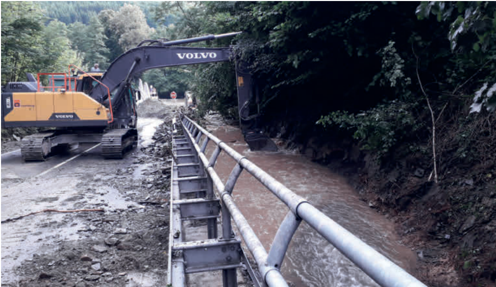
Nach dem Hochwasser sorgten unterspülte und abgerutschte Böschungen entlang der B 236 dafür, dass die WFA E tagelang von der Außenwelt abgeschnitten blieb.
