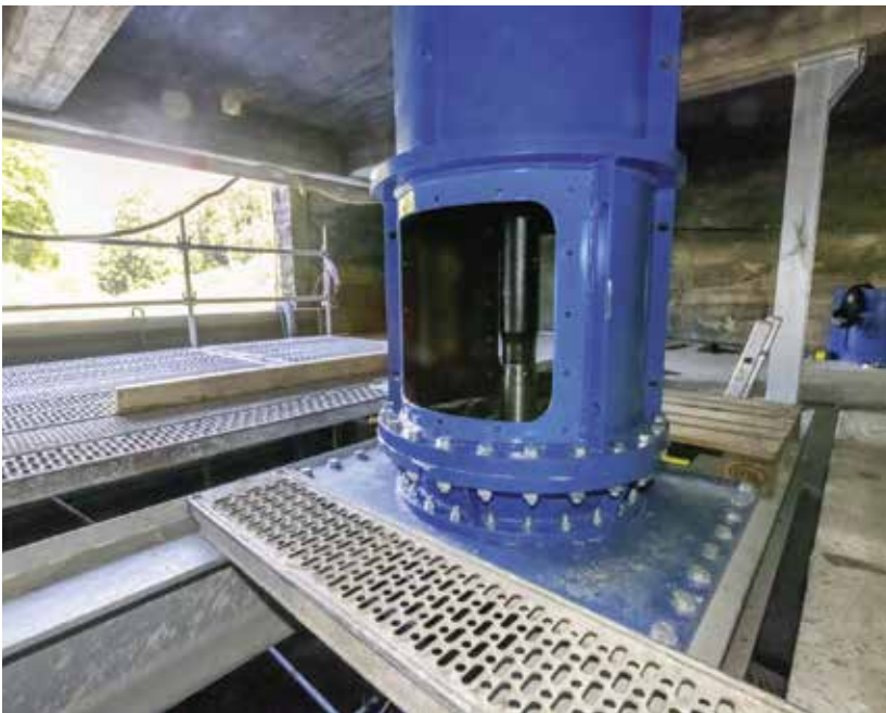
Mit der neuen Mindestwasserturbine im Kraftwerk Ahausen können nun auch geringere Wasserabgaben als zuvor zur Stromproduktion genutzt werden.
